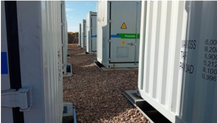
Solaria impulsa su apuesta por el almacenamiento con 480 MWh adicionales en Castilla-La Mancha
