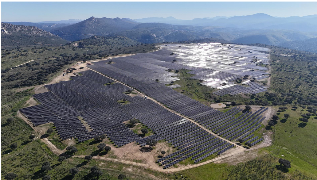
Parque fotovoltaico construido por Aldesa.
