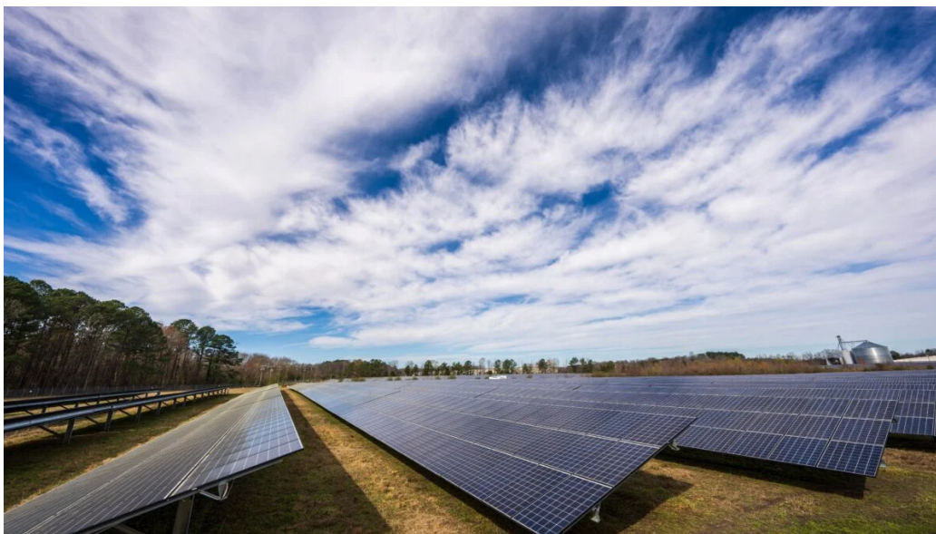
Planta de energía fotovoltaica.
