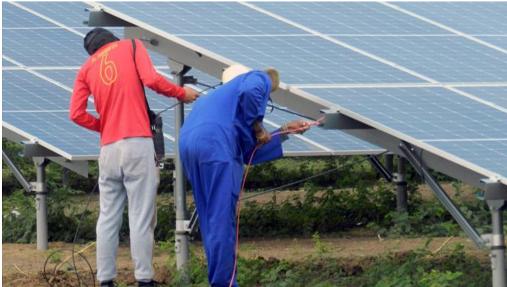
Parques solares de La Yuca y Mal Tiempo en Cienfuegos (Cuba).
