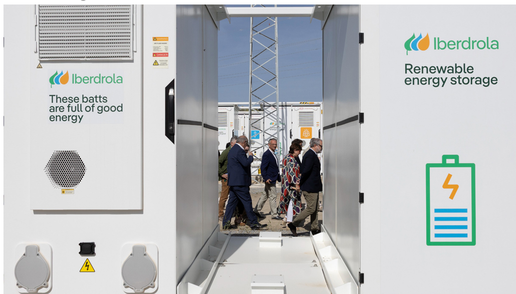
Iberdrola inaugura la mayor batería de almacenamiento de energía de España, con 120 MWh, en el complejo Campo Arañuelo (Cáceres).
