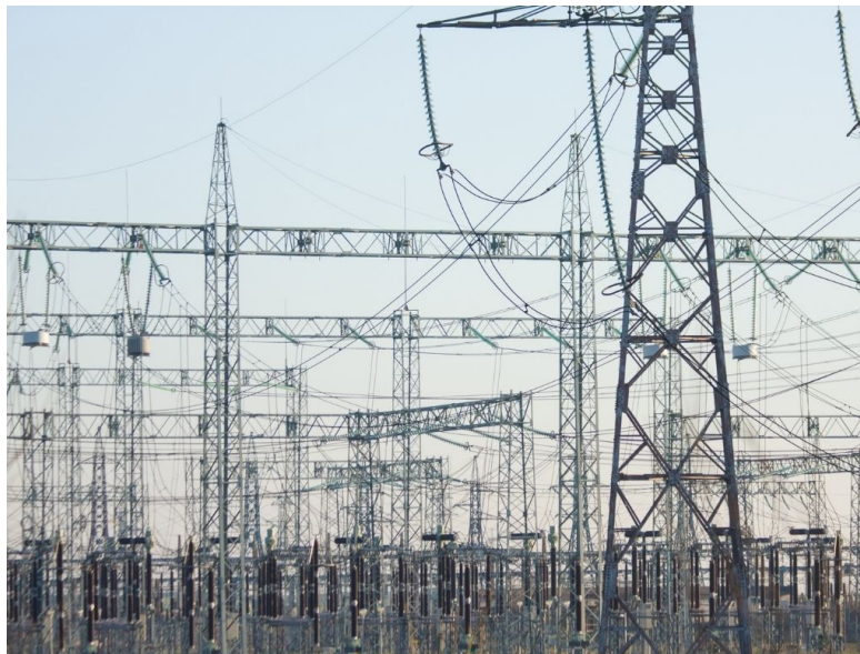
Euskadi Inversion redes electricas
