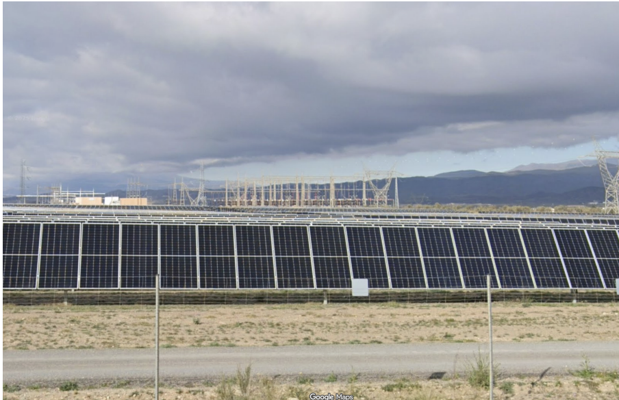
Tabernas (Almería), el nudo de la red donde la fotovoltaica pierde casi la mitad de la energía que genera
