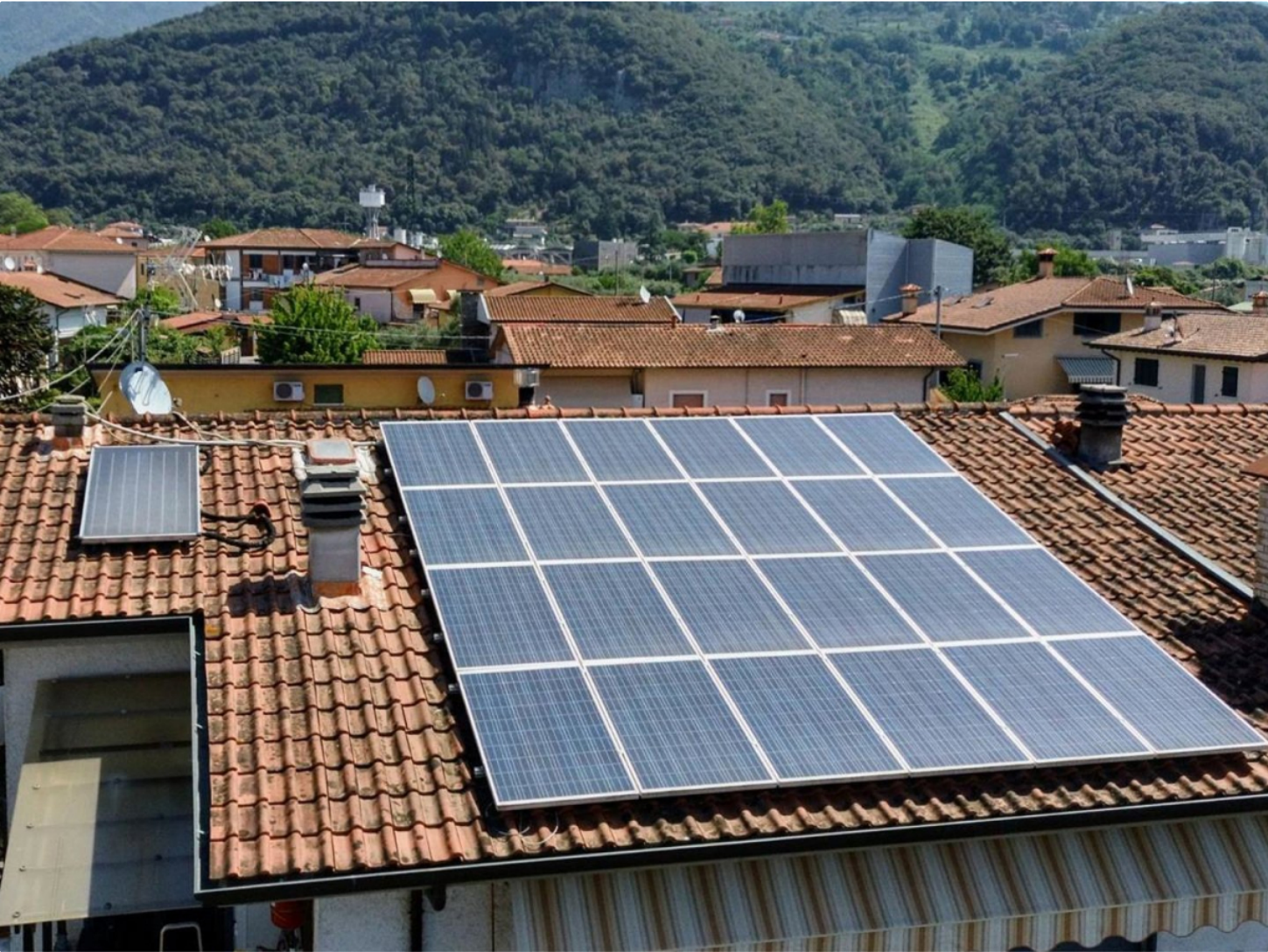
Instalación fotovoltaica UNEF
