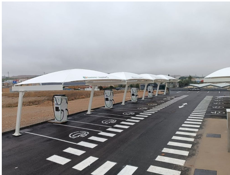
Iberdrola | bp pulse pone en servicio en Tudela su mayor hub de recarga ultrarrápida en Navarra.
