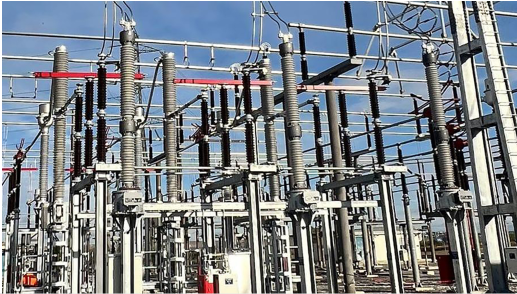
Red Eléctrica culmina la nueva subestación San Fernando (Madrid) que facilitará el desarrollo de centros de datos en el Corredor del Henares.
