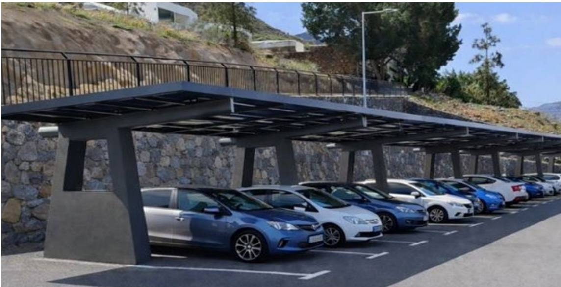
El Cabildo de Gran Canaria licita una planta solar con baterías en el aparcamiento del camposanto de Mogán
