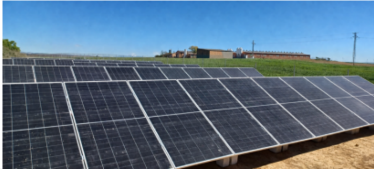
El Ayuntamiento de Agramunt instala un autoconsumo compartido en la potabilizadora municipal
