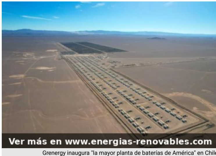
Greenergy inaugura "la mayor planta de baterías de América" en Chile
