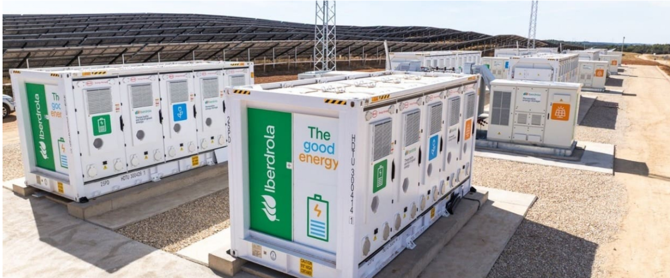
Batería Romeral de Iberdrola en Cuenca (CLM). IBERDROLA
