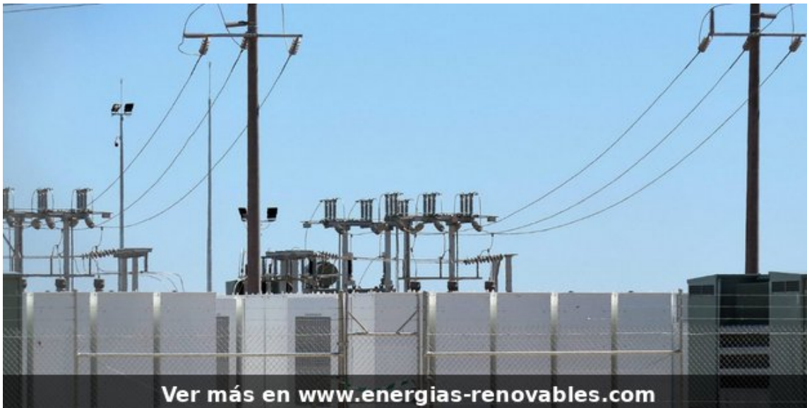
Capital Dynamics entra en el mercado irlandés con una batería de 170 MW
