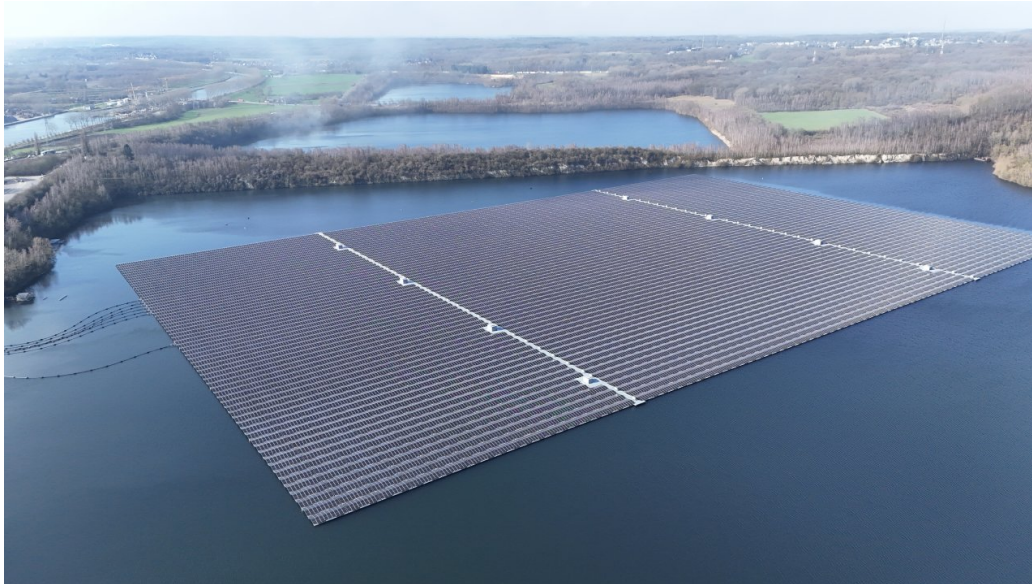
Planta fotovoltaica flotante de Holcim junto a su fábrica de cemento en Obourg
