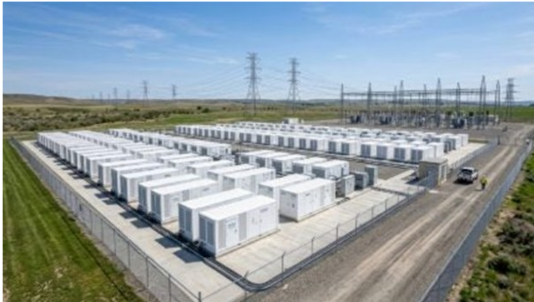
Batteriespeicher, Noveria Energy, Deutschland, Tennet
