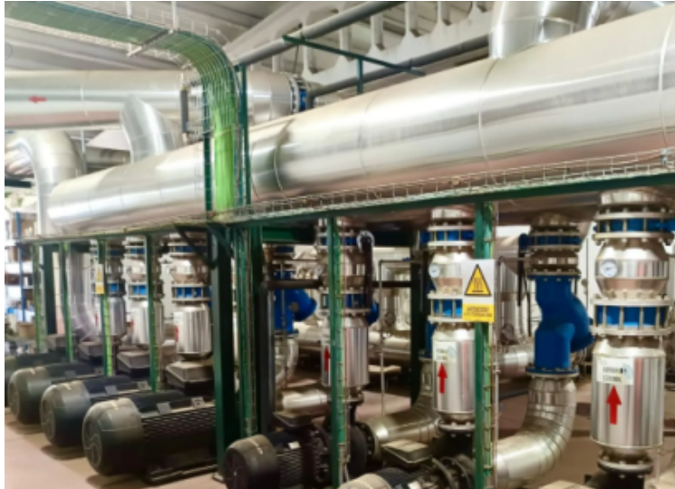
Tres centros sanitarios de Guadalajara se conectan a la Red de Calor y sustituyen gas y gasóleo por energía renovable
