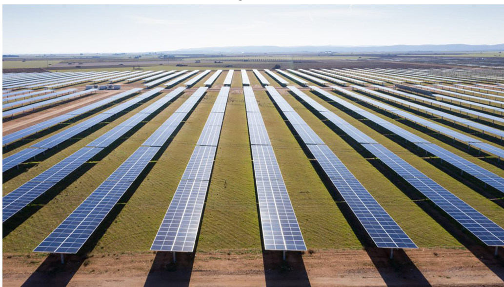
Planta fotovoltaica de Cox.
