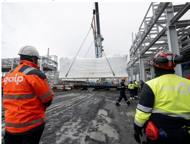
Galp completa la instalación de los 100 MW de electrólisis en la refinería de Sines (Portugal).
