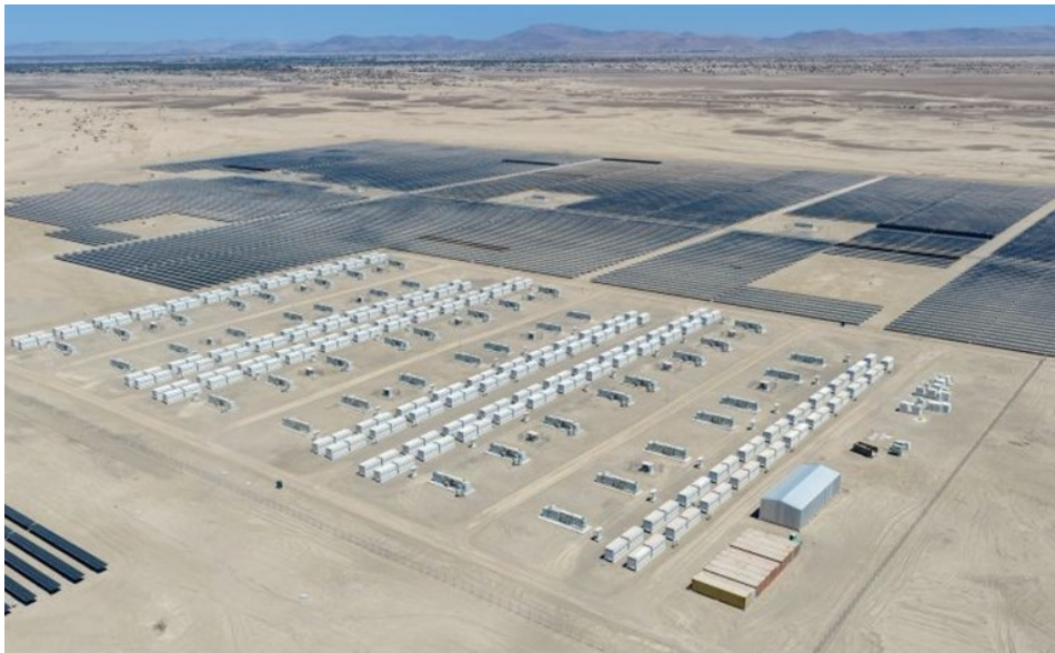
Planta híbrida de energía solar y almacenamiento en batería Víctor Jara.
