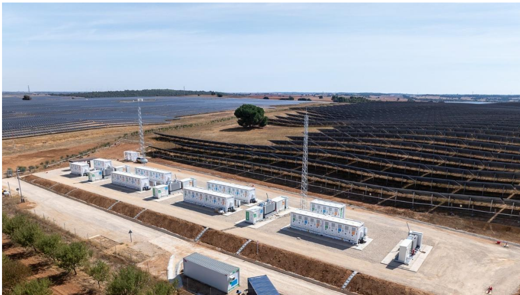
Campo de baterías en Cuenca.
