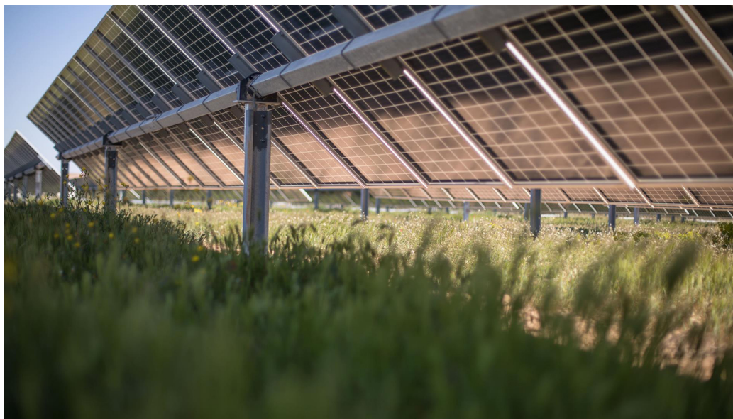
Instalaciones fotovoltaicas de Lightsource bp.
