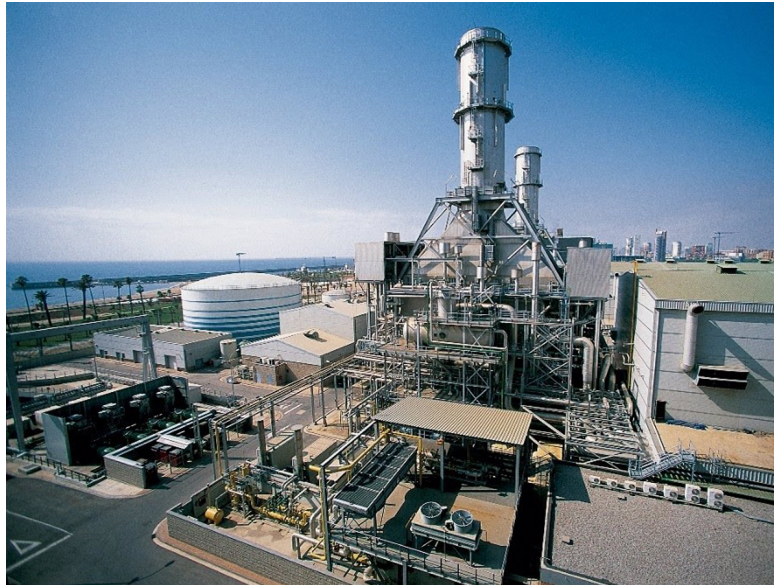
Central térmica de ciclo combinado (CTCC) de Endesa en Sant Adrià de Besòs (Barcelona). FOTO: Endesa
