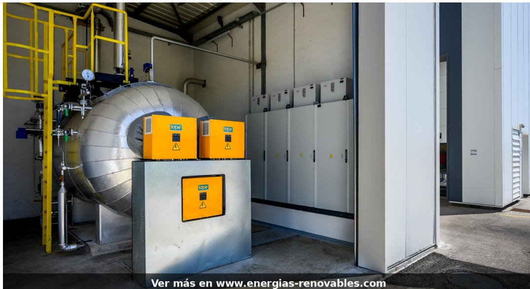
Caldera eléctrica de 2,7 megavatios en la planta industrial de Paper Prime, en Vila Velha de Rodão. EDP
