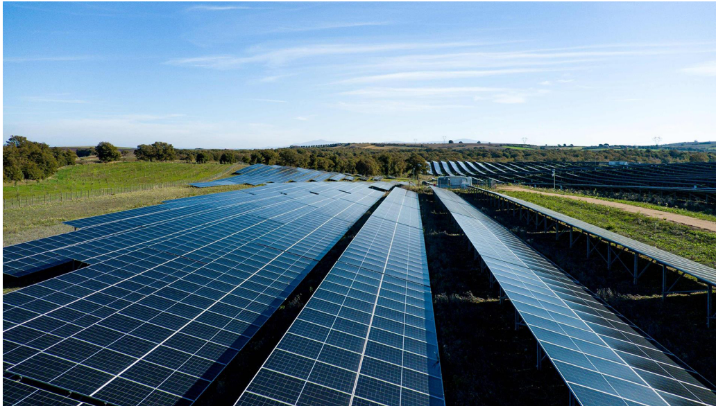
Planta solar de Iberdrola.
