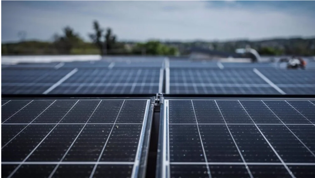
Instalación solar de autoconsumo de Greenvolt Next.
