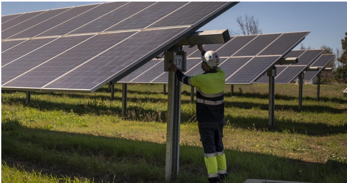
Foto de archivo de una planta fotovoltaica.
