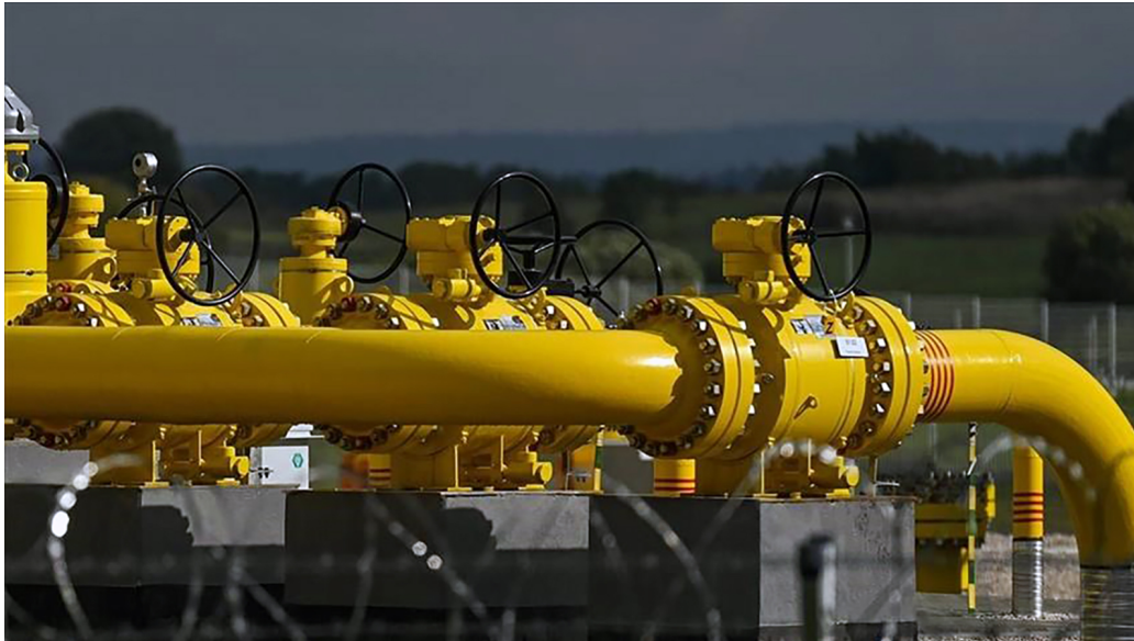
Instalaciones de gas de Grupo MET.
