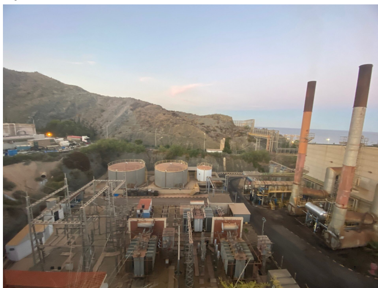
Planta de cogeneración.
