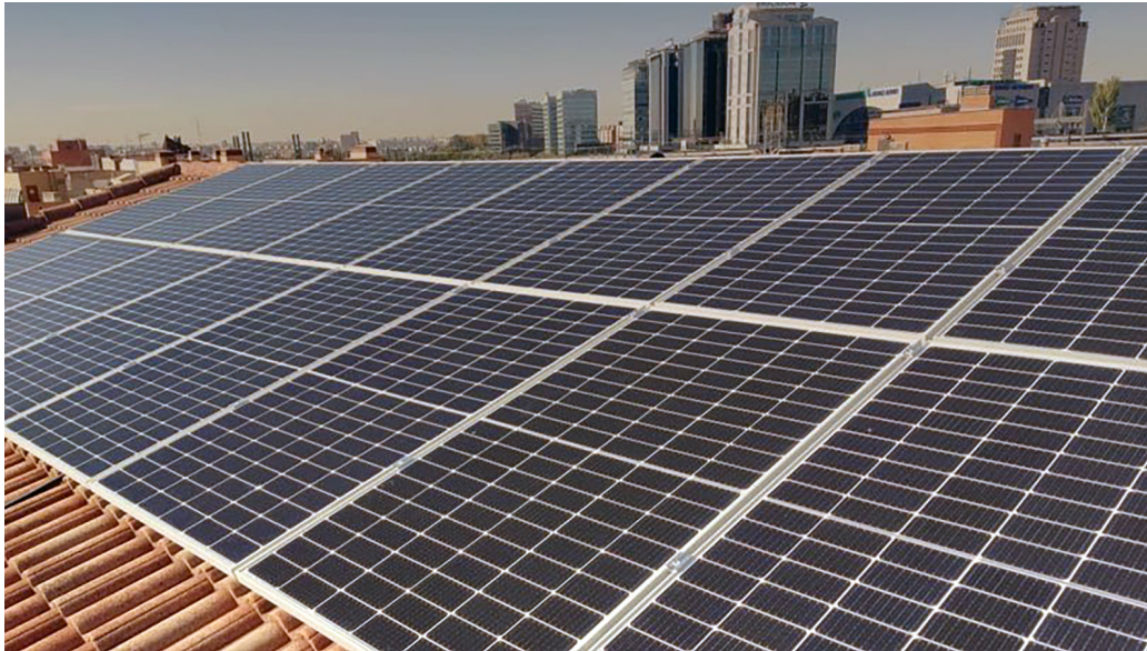
Instalación de autoconsumo de Ecooo Energía Ciudadana.
