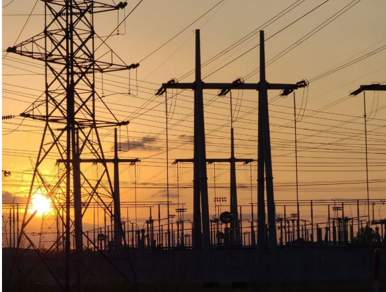
red electrica alta tensión
