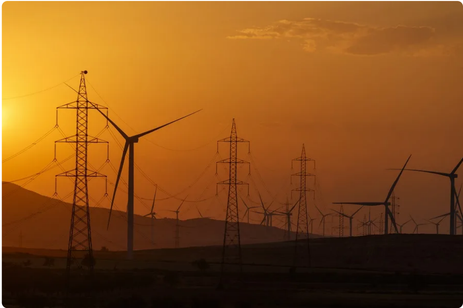
Torres eléctricas a la altura de la población zaragozana de Magallón. EFE/Javier Belver
