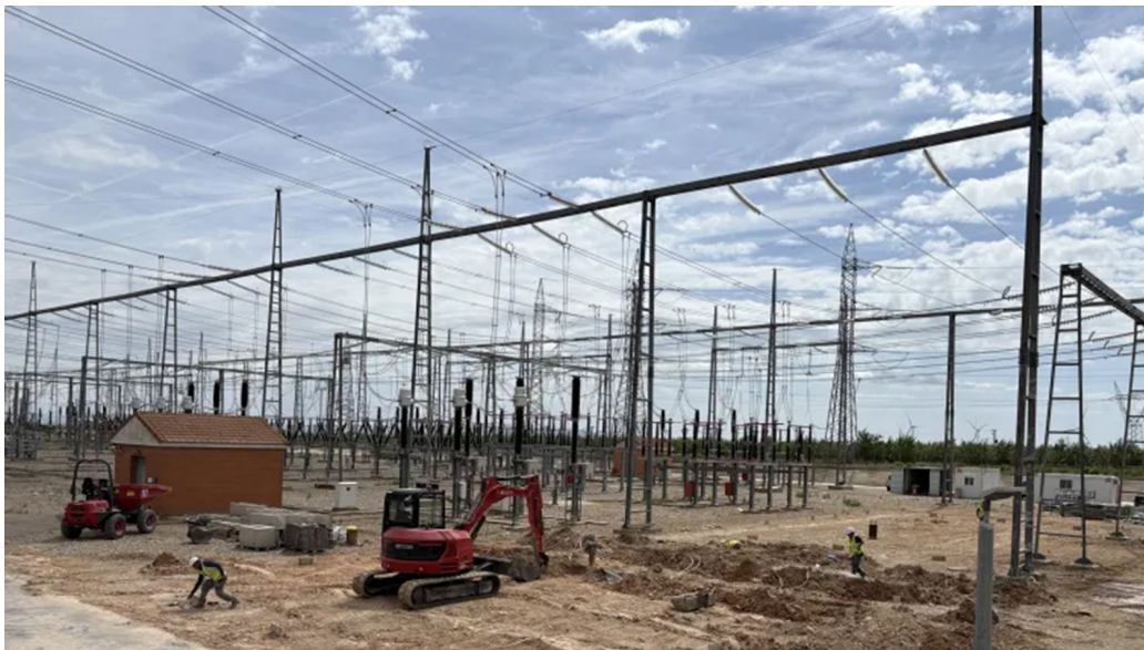
Red Eléctrica amplía la subestación de Magallón para impulsar el tejido industrial y reforzar la red de transporte en la provincia de Zaragoza.
