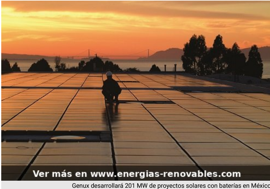
Genux desarrollará 201 MW de proyectos solares con baterías en México
