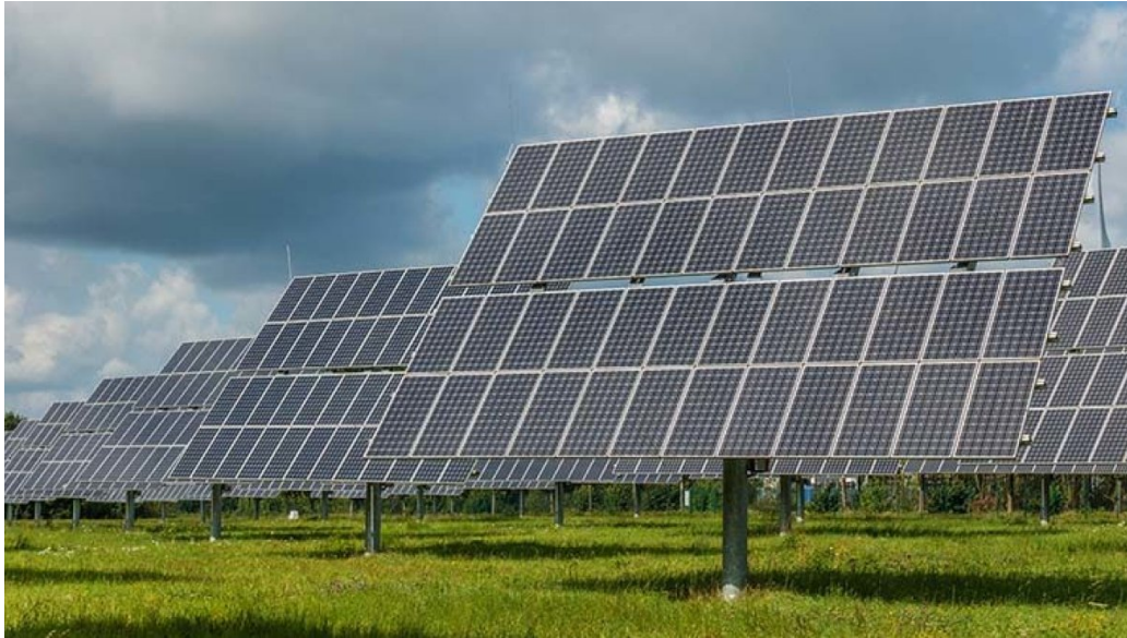
Paneles de energía solar
