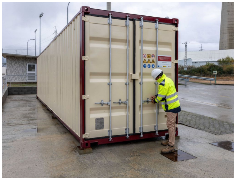
CIUDEN completa un sistema híbrido de almacenamiento con tres tecnologías de baterías para producción de hidrógeno verde.
