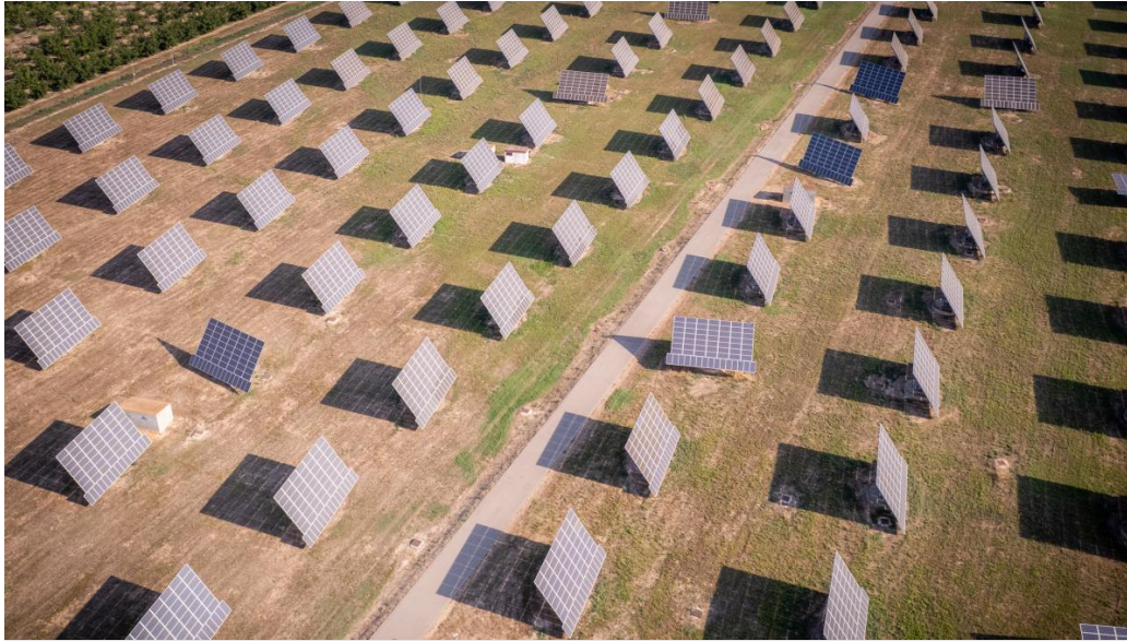
Una instalación fotovoltaica en Lleida
