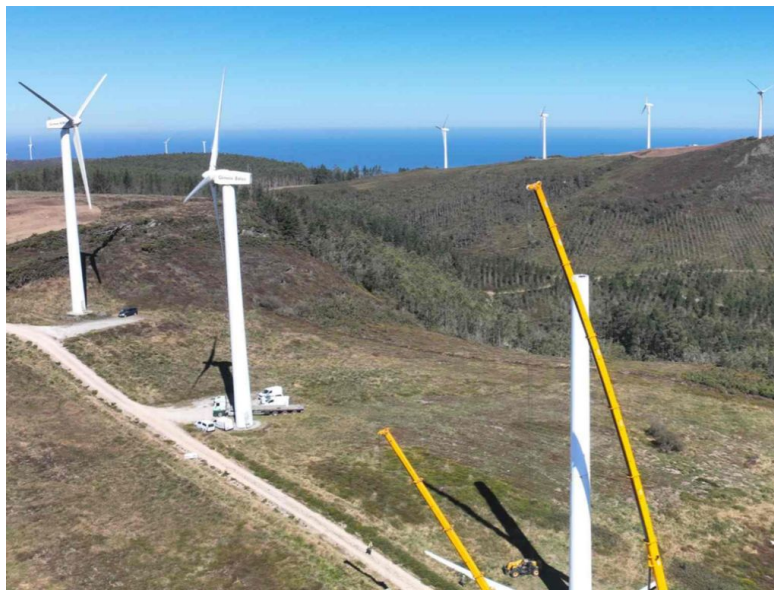
parque eólico Coriscada en Galicia
