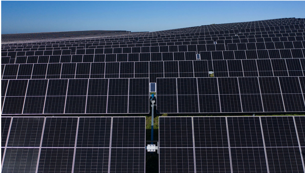
Planta Fotovoltaica Celso & Prisca, Jerez de la Frontera, Cádiz (España).
