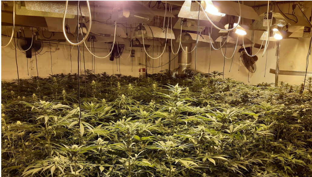
Plantación de Marihuana, enganchada ilegalmente a la red eléctrica.
