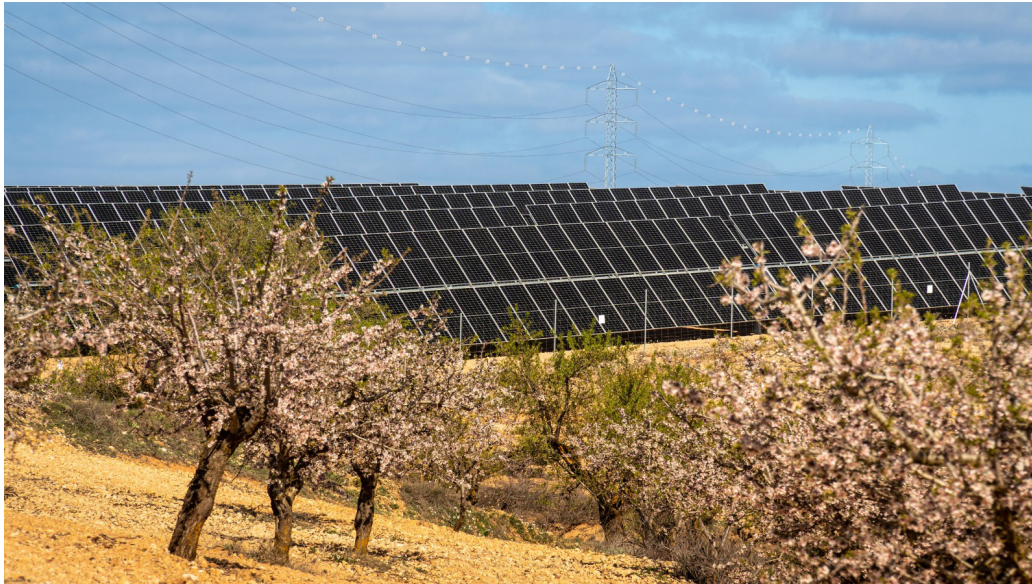
Planta fotovoltaica Covatillas de Sonnedix.
