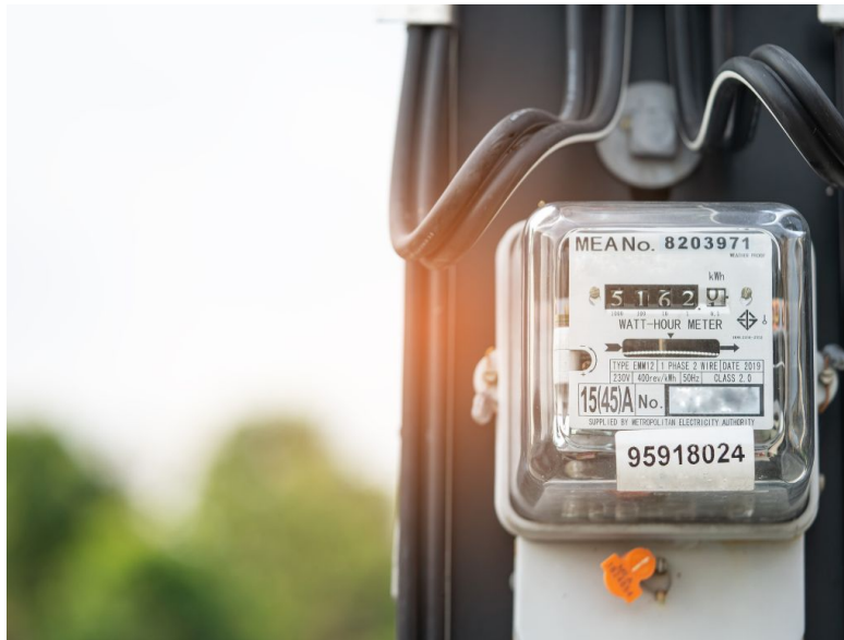
seguridad de suministro eléctrico
