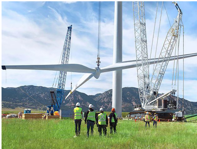
Instalaciones eólicas de Forestalia. FOTO: Forestalia
