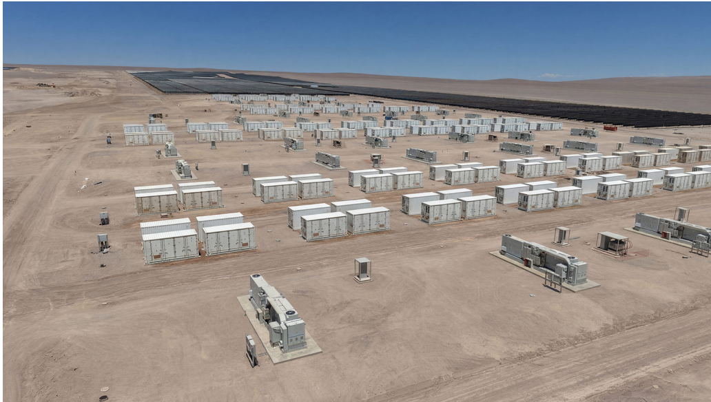
Fase 4 de la plataforma Oasis de Atacama de Grenergy en Chile.
