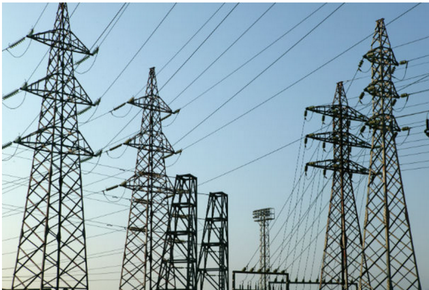
Endesa pone el foco en la red eléctrica ibérica con 5.500 millones en inversiones
