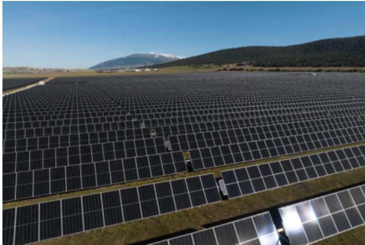
Los parques fotovoltaicos Trévago 1 y 2 de Soria certifican su sostenibilidad con el sello de excelencia de UNEF
