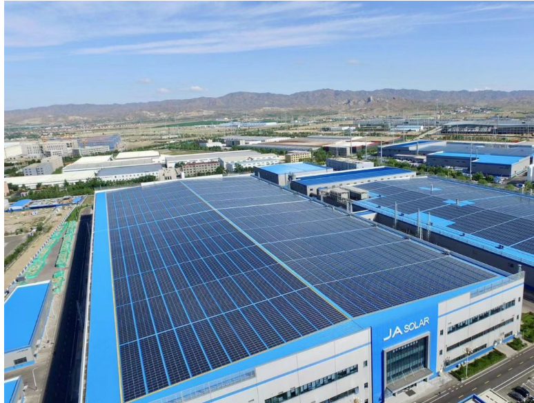
JA módulos solares fotovoltaica
