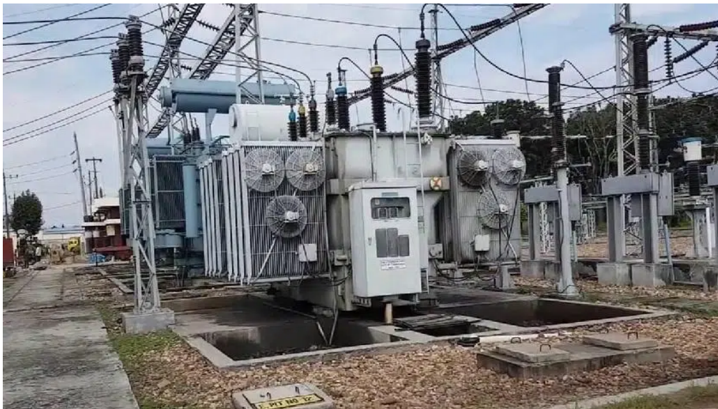
Se prevé que el mercado mundial de equipos de alta tensión crezca rápidamente hasta 2030
