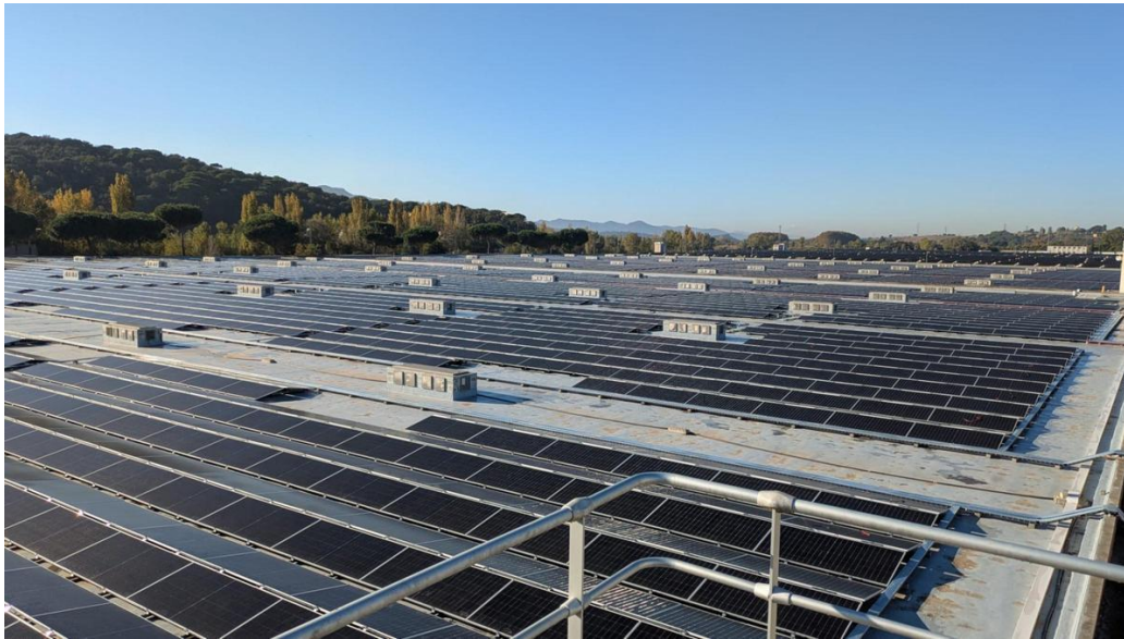
Imatge del parc fotovoltaic situat a l'ETAP Ter, entre Cardedeu, Llinars i la Roca del Vallès.
